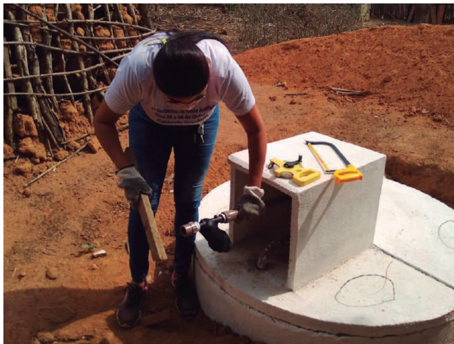
Técnica fazendo a montagem do motorbomba em cima do tanque de reúso para o sistema de irrigação.
